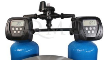
Abb. 2: 2x Steuerventil Clack WS 1 CI mit Verrohrung und Motor
